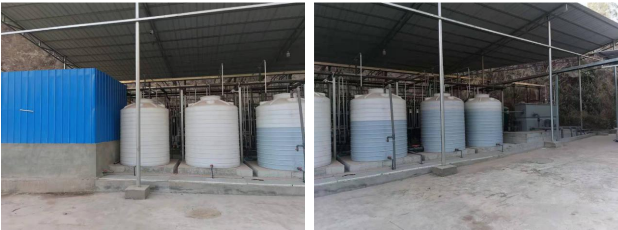
雨季渗滤液处理系统
