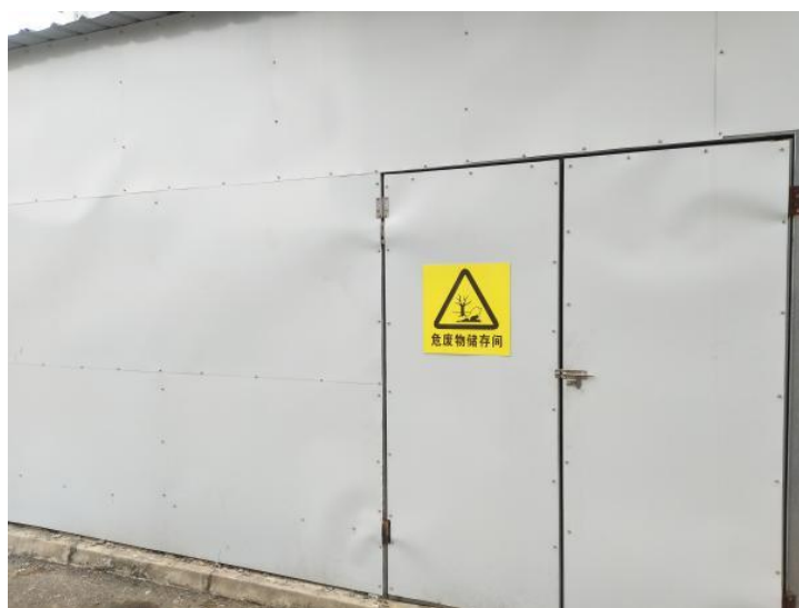
图 3-5 本项目危废暂存间现场图
